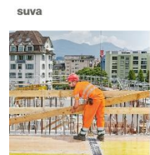
Misure proprie al cantiere per garantire la sicurezza e la tutela della salute Strumento di pianificazione
